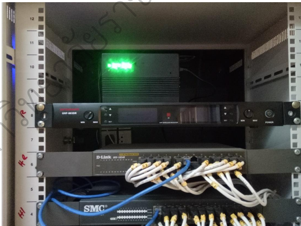
รูปที่ ข-15 ภาพการติดตั้ง Node MCU Server ในพื้นที่จริง
